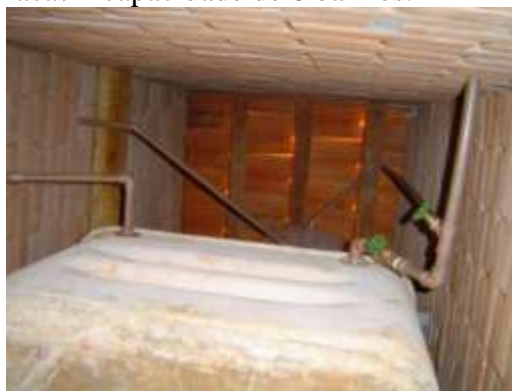
Fig.12: Vista de baixo para cima no banheiro: caixa d’água fria e, acima, bombona instalada.
