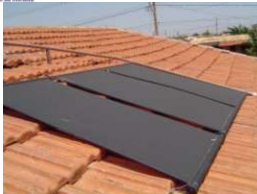
Fig.10: Painel para aquecimento solar c/ 3 placas – capacidade de 6 banhos.
