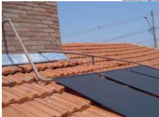
Fig.9: Painel para captação de energia solar instalado.
