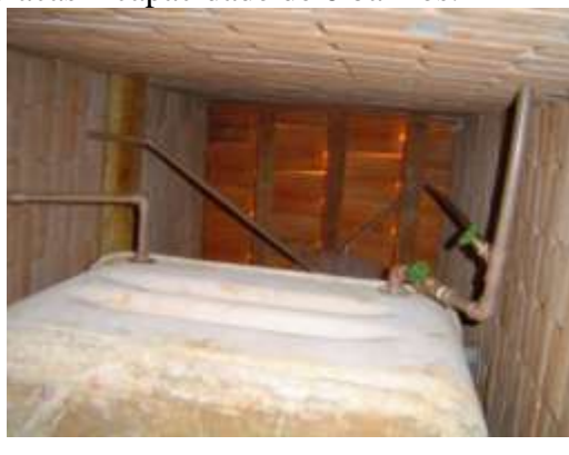
Fig.12: Vista de baixo para cima no banheiro: caixa d’água fria e, acima, bombona instalada.
